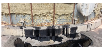
Fuite en cours.
