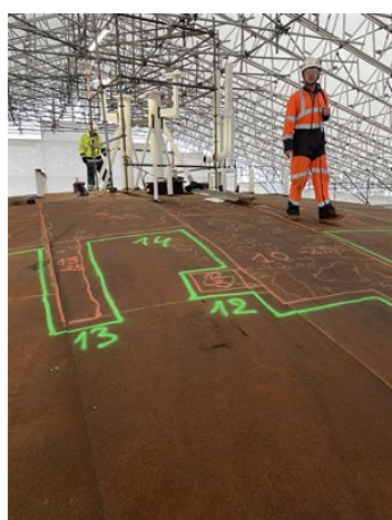
Toiture avant application du système Belzona.
