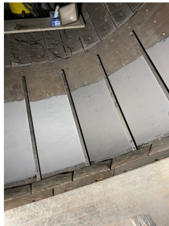
Defekte Oberfläche aufgebaut mit Belzona 4111 (Magma-Quartz).
