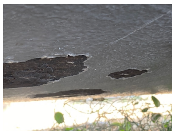
Zonas afectadas por corrosión.
