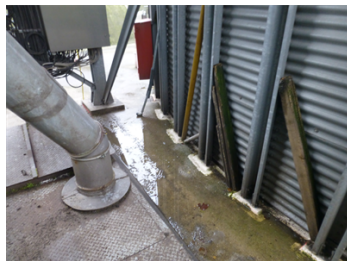
Zustand der Problemzonen
