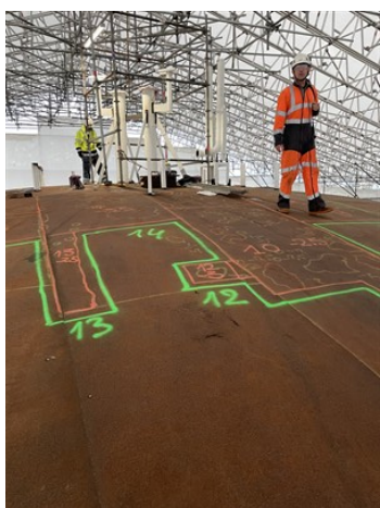
Toiture avant application du système Belzona.
